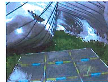
写真46 倒壊したハウスの状況（内側）
