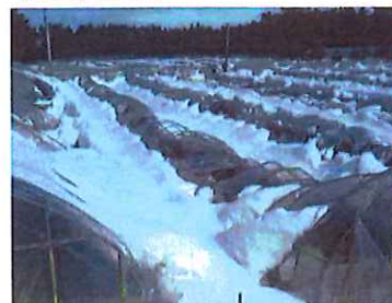
写真45 倒壊したハウスの状況（外側）
