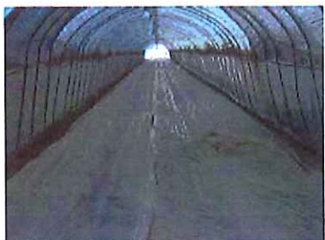
写真 49 被覆資材を修復後(奥側)に、緊急的にべたがけ被覆により保温した状況
