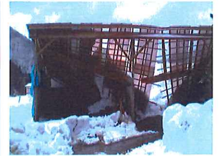
写真 38 堆肥舎屋根の損壊状況
