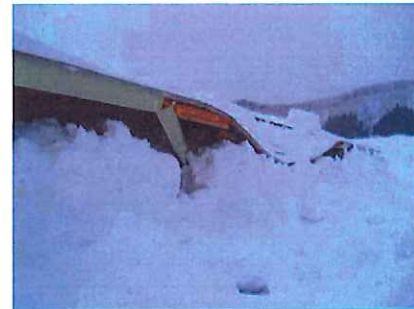
写真 37 畜舎軒先の損壊状況
